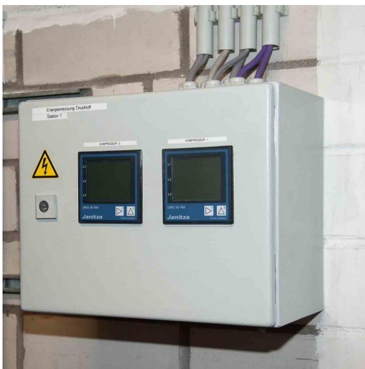
Optional für eine zukünftige, aktualisierte Fassung: Im nächsten Schritt soll auch der Druckluftverbrauch erfasst werden. Die Messtechnik wird gerade vorbereitet.
