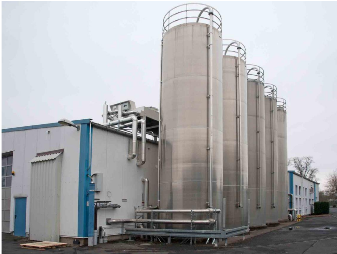
Der neue Freikühler auf dem Hallendach versorgt die Zisterne unter den Silos mit Kaltwasser.
