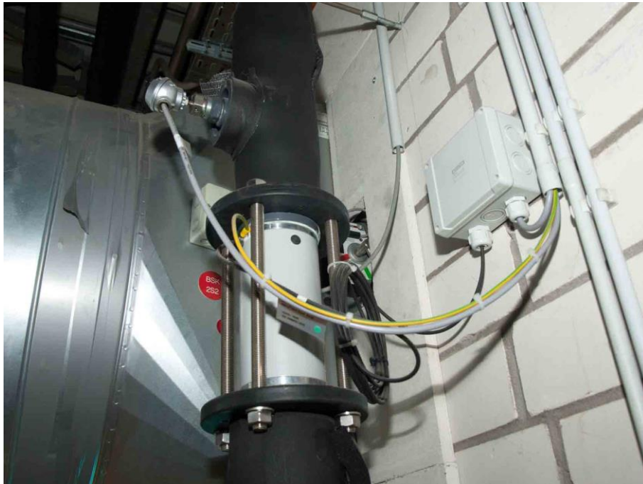
Durchflussmesser mit Temperaturfühler erfassen die Kaltwassermengen und sind über den Modbus mit der Visualisierung verbunden.
